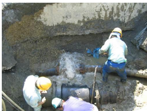
▲ 本管の漏水事故
