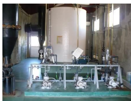
▲ 次亜塩素酸ナトリウム注入設備
