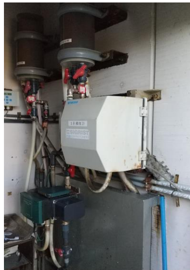
▲ 濁度計 (東第2浄水場)
