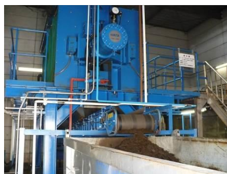
▲ 加圧脱水設備
