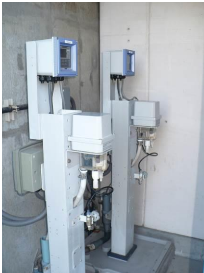
▲ 残留塩素計 (東第2浄水場)
