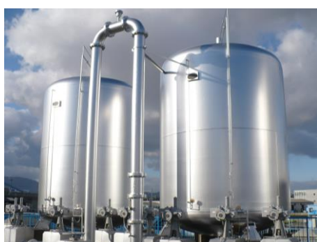
▲ 圧力式急速ろ過機
