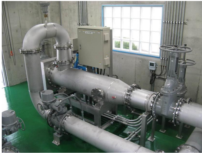
紫外線処理設備（東第2浄水場）
