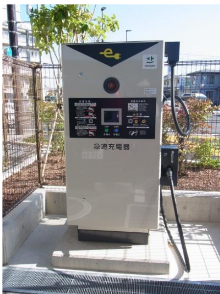
西山天王山駅東駐車場急速充電器 (平成 25 年 12 月設置)
