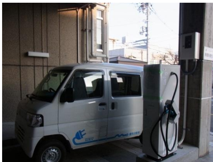
市役所本庁舎前駐車場急速充電器 (平成 26 年 2 月設置)
