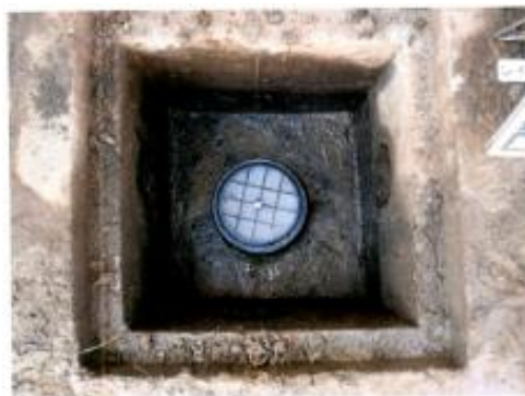
浸透施設（長岡第四中学校地内）
