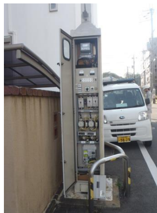
[天神マンホールポンプ制御盤 外景]
