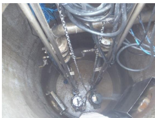
[天神マンホール内部 ポンプ等設置状況]
