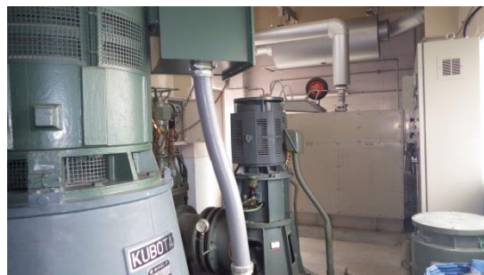
[神足ポンプ場 内部]
