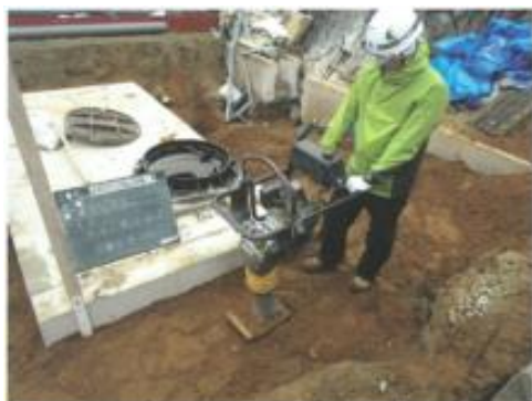
貯留施設（長岡第四中学校地内）
