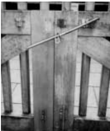
水上橋入口のカギが壊される
