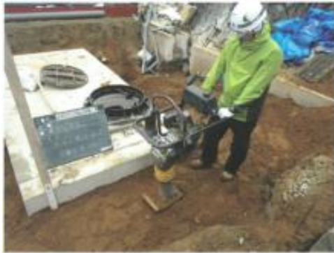
貯留施設（長岡第四中学校地内）
