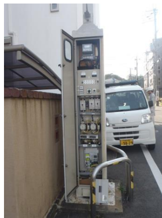
[天神マンホールポンプ制御盤 外景]
