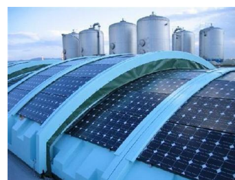
東第二浄水場太陽光パネル
