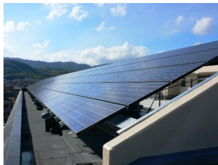
長岡第七小学校太陽光パネル
