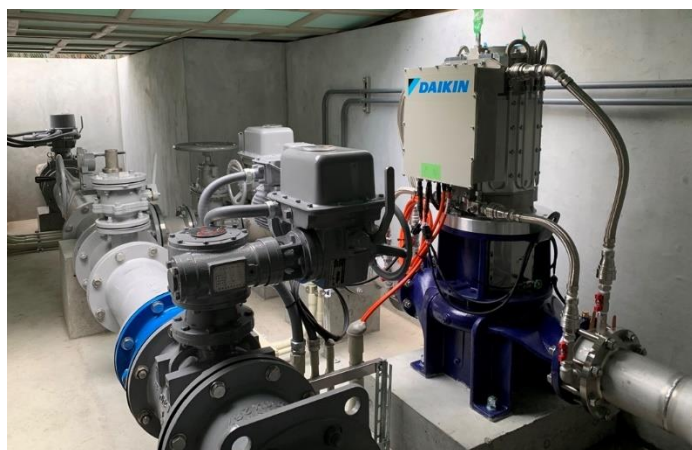
図 7 東配水池（水道施設）に設置した小水力発電機（22kW クラス）
