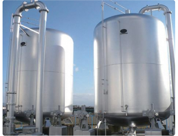
東第2浄水場のろ過機
