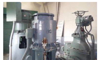
神足ポンプ場 (内部)
