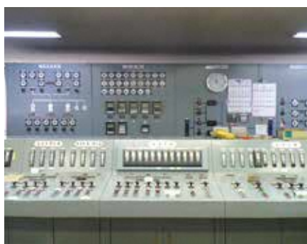
現在の中央監視操作設備
