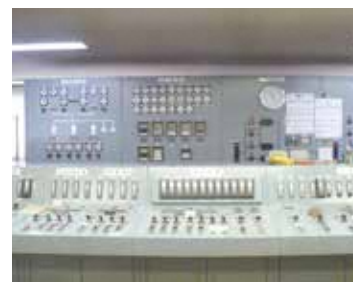
▲現在の東第2浄水場中央監視操作設備
