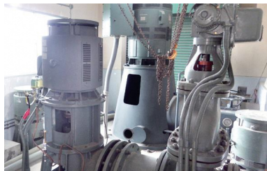
現在の雨水ポンプ場(内部)
