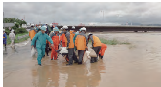
写真：平成25年(2013年)9月台風18号 桂川が久我橋付近で約400mにわたり越水。2,000個の土のうを積み、堤防決壊を防いだ。
