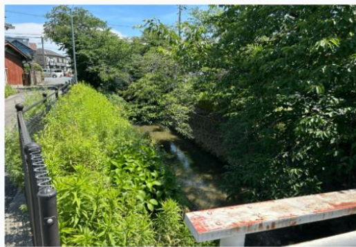
雑草の繁茂状況
