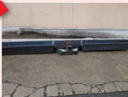
落下した欄間看板
