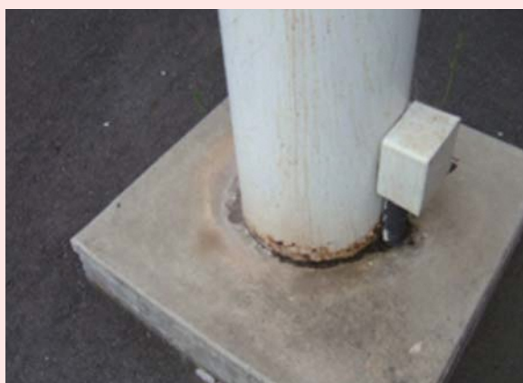
ポールの根元にサビが発生
