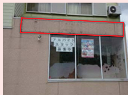
落下した後の壁面
