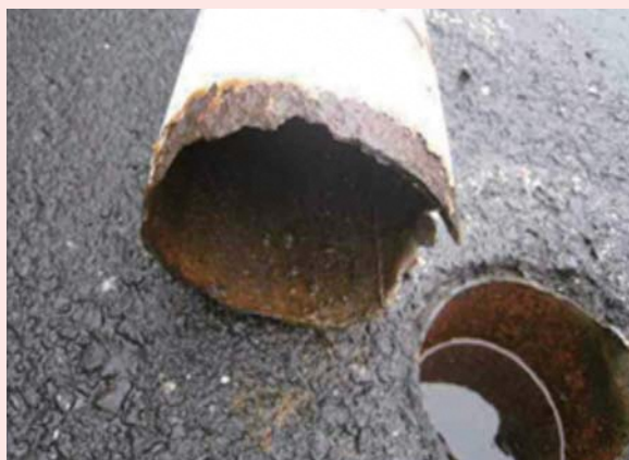
ポールの根腐れによる倒壊
