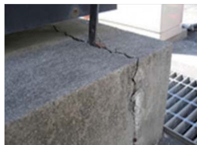
看板基礎のひび割れ
