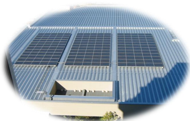
バンビオにある太陽光パネル
