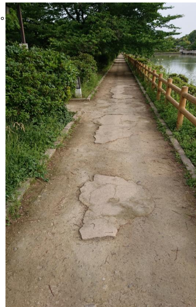
■路盤面の割れ、凹み、転圧剥がれなど損傷が著しい歩道現状
