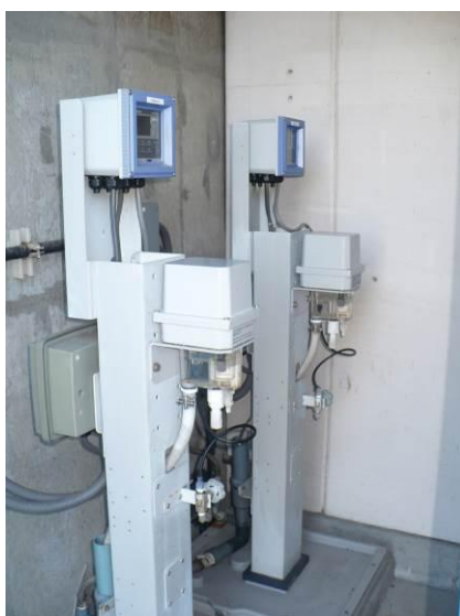
▲ 残留塩素計 (東第2浄水場)
