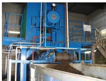
▲ 加圧脱水設備
