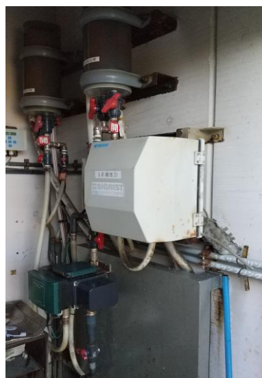
▲ 濁度計 (東第2浄水場)
