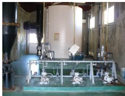
▲ 次亜塩素酸ナトリウム注入設備
