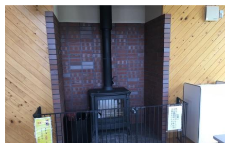
西代里山公園管理棟の薪ストーブ
