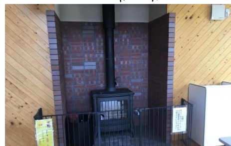
西代里山公園管理棟の薪ストーブ
