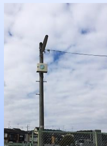
実際に設置されている 固定受信器の 写真
