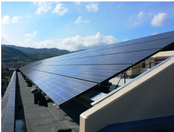
太陽光パネル（校舎屋上）
