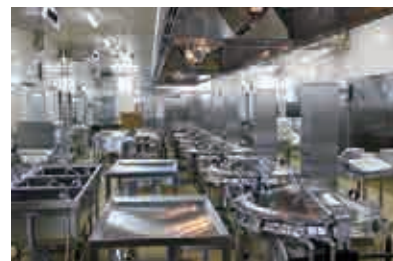
中学校給食の導入に向けて完成した長十小の北部共同調理場。
