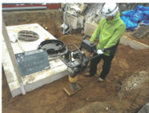
貯留施設（長岡第四中学校地内）
