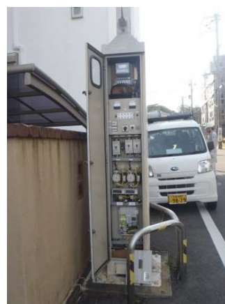
〔天神マンホールポンプ制御盤 外景〕
