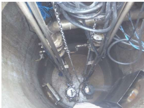
〔天神マンホール内部 ポンプ等設置状況〕
