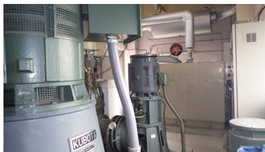
〔神足ポンプ場 内部〕
