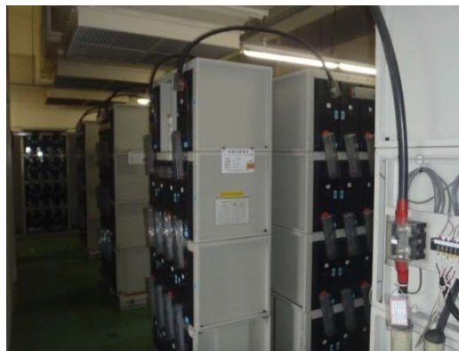
[今里雨水ポンプ場 電気棟 1F 蓄電池室]
