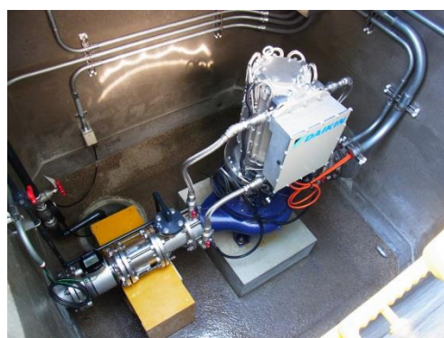
図10 マイクロ水力発電設備(22kW クラス)
