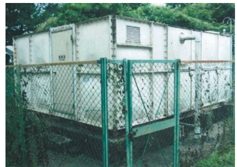
▲長岡第三中学校の貯水槽
