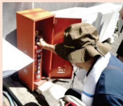
消火器等設備の確認
