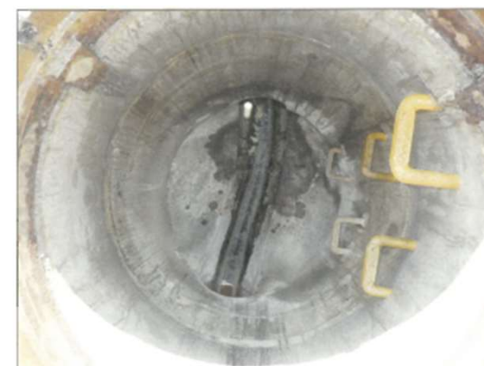
着手前 人孔不良 壁面腐食
