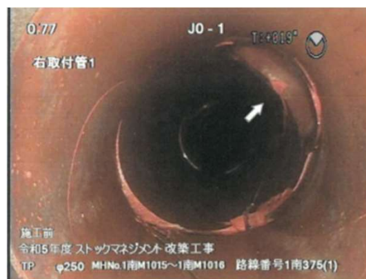
着手前 管渠不良 クラック
